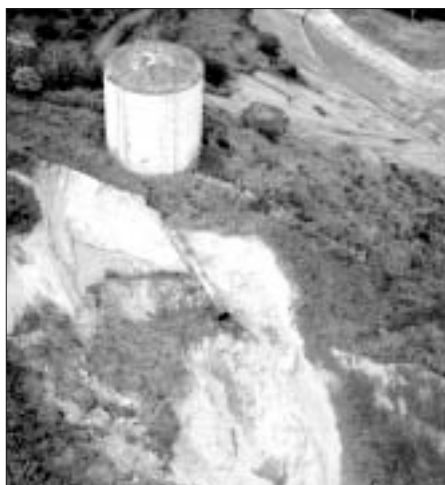
Deslizamiento en tanque de almacenamiento
